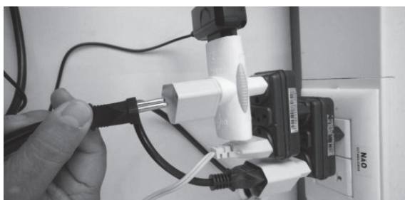
FIGURA 17.10. Exemplo de uma tomada sobrecarregada.
